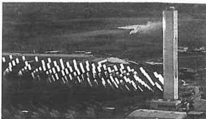
Planta termosolar de Atlantica Yield, antigua Abengoa Yield, en Sevilla, España
