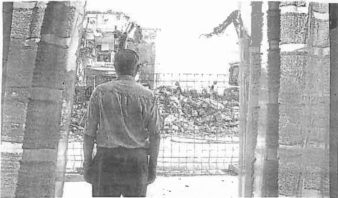
Un vecino de Los Pajaritos observa la demolición de los edificios que ya deberían haber empezado a reconstruirse. / Pepo Herrera
