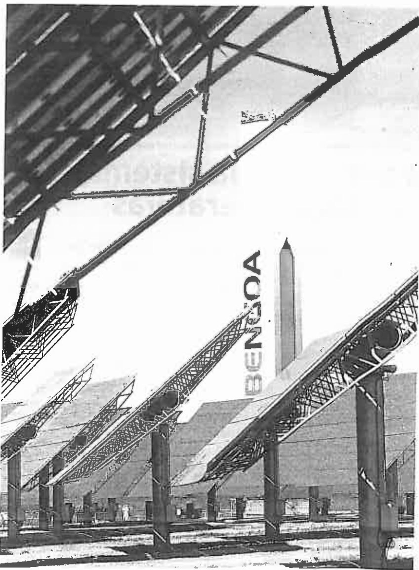
Planta solar con tecnología de torre en el término municipal de Sanlúcar La Mayor. / Pepo Herrera
