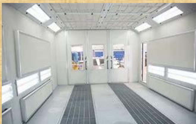
Cabina de pintura
